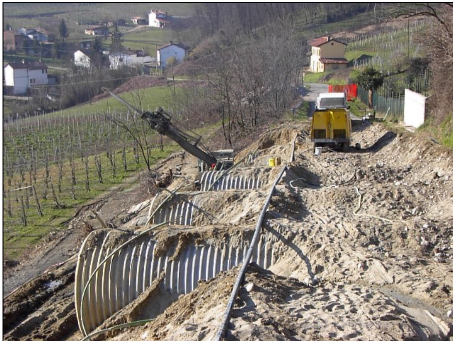
Intervento di risanamento versante in località Amistà / Rile In primo piano i grossi tubi \Phi 200 cm posizionati nella seconda metà degli anni '70
