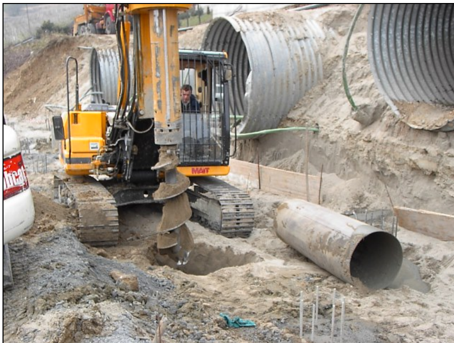
Intervento di risanamento versante in località Amistà / Rile Realizzazione di pali di fondazione di medio diametro \Phi 500 mm
