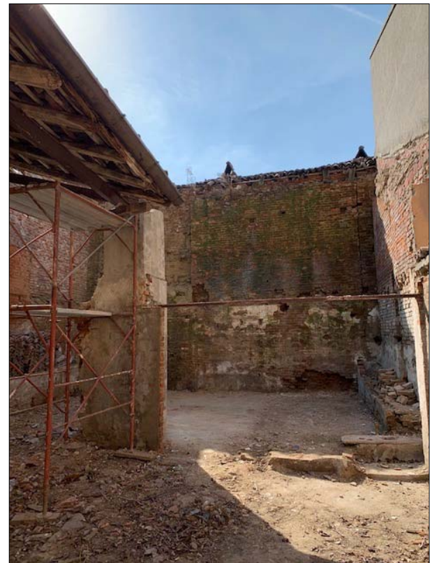
Fotografie 3-4: rustico-fienile crollato e recentemente demolito
